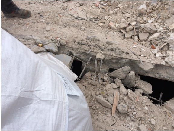
Foto 4: Bootshalle 2 im Bereich der Treppe zur Küche
