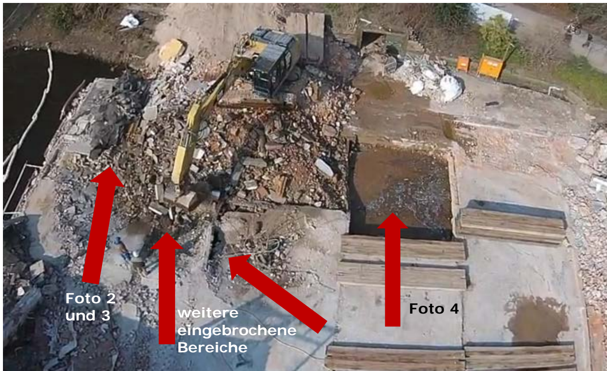
Foto 1: Luftbild mit Darstellung der eingebrochenen Bereiche
